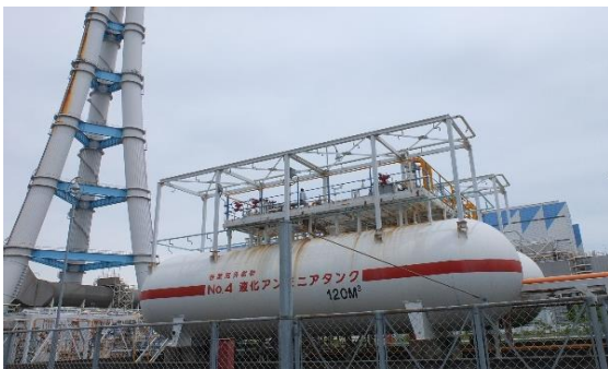
液化アンモニアタンク
